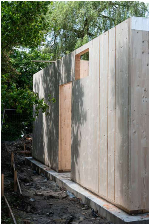
De eerste hoogspanningscabine in CLT is een feit!
